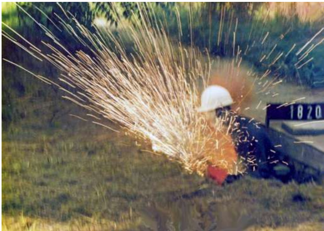
Bild 13: Lichtbogen in einer Kabelmuffe mit 380 V, 5 kA, 82 ms
