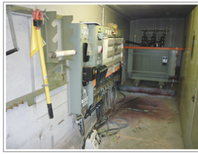
Schaltstation nach dem Störlichtbogenunfall (Foto: BG ETEM)
