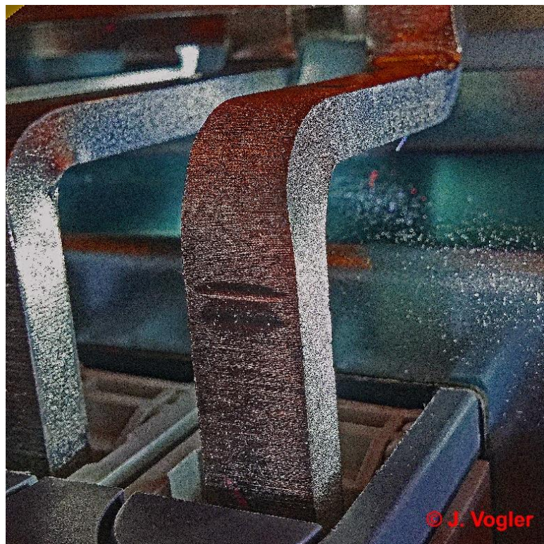
Bild 12: Ansicht eines Leistungsschalter Anschlusses in einem staubgeschützten Raum mit sehr viel Krümelwhisker
