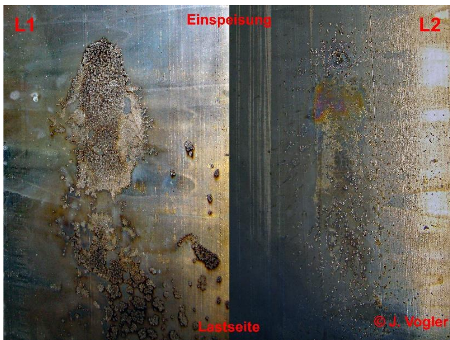
Bild 7: Ansicht einer Zündstelle in einem Schienenkanal
